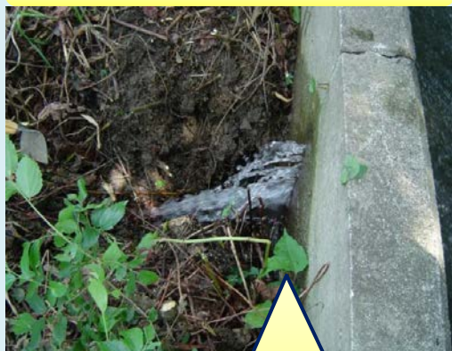
目地の開き (漏水)
