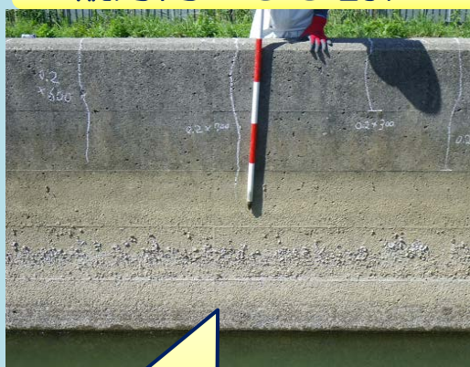
縦方向のひび割れ
