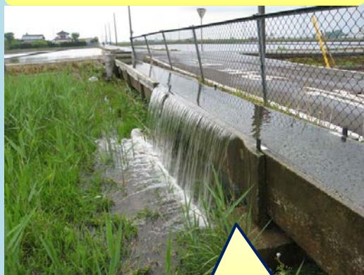
沈下による溢水
