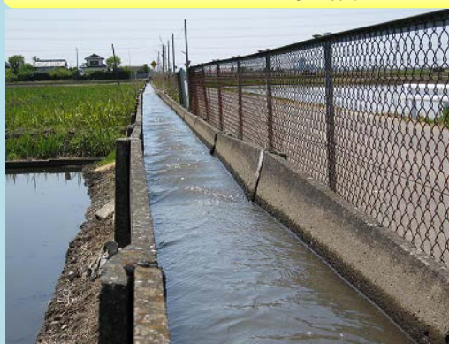
沈下による変形
