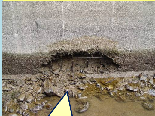
鉄筋が露出した欠損
