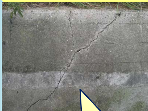
斜め方向に走る割れ
