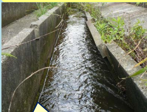
水路側壁の変形
