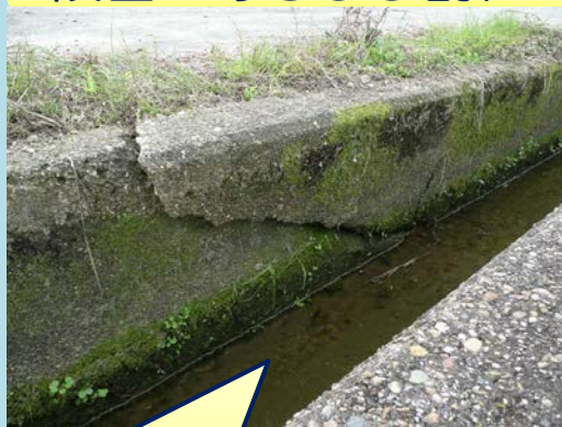
段差のあるひび割れ
