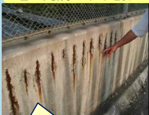
短い間隔のひび割れ
