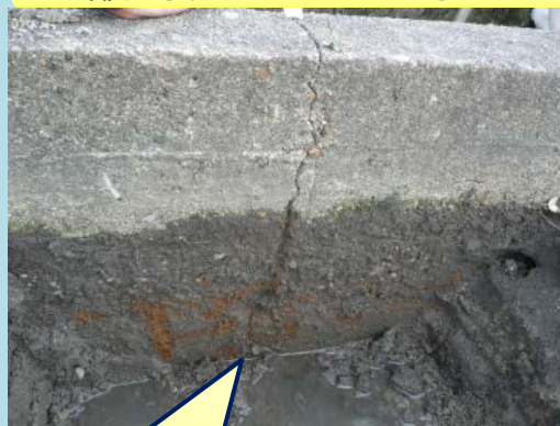
縦方向のひび割れ
