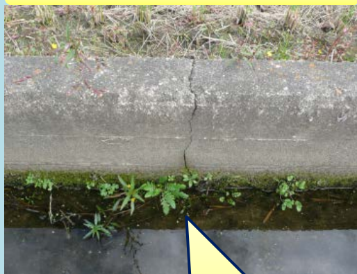
縦方向のひび割れ
