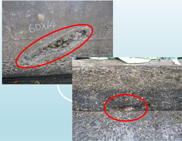
水路の壁にあいた穴
