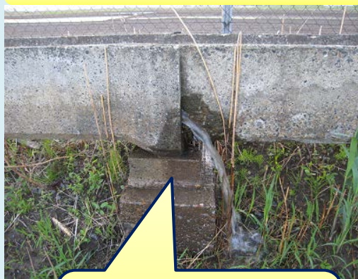
目地の開き (漏水)
