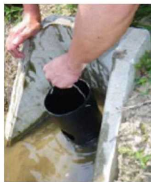
降雨前に調整管を上げる (フリードレーン横穴方式)
