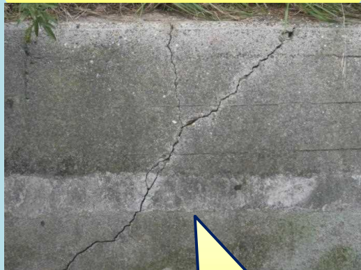
斜め方向に走る割れ
