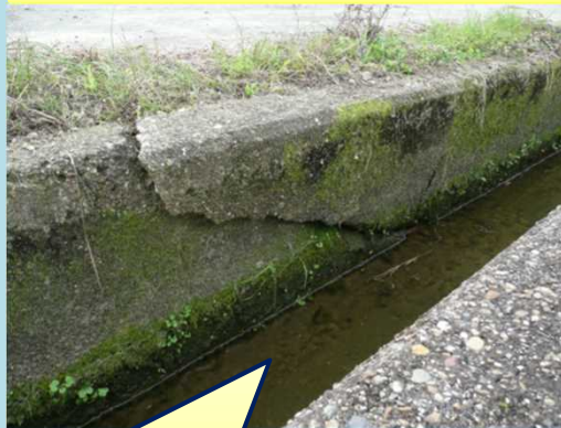
段差のあるひび割れ
