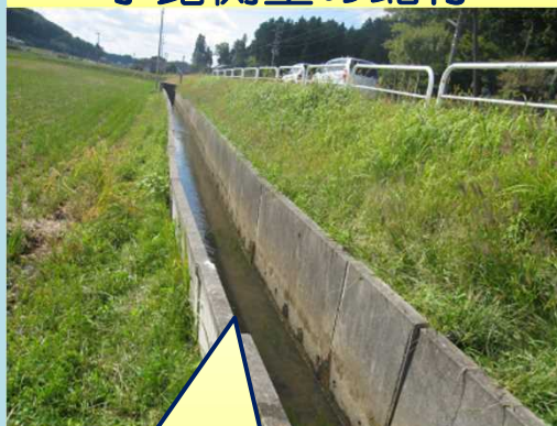
水路側壁の蛇行
