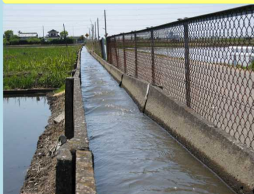
沈下による変形
