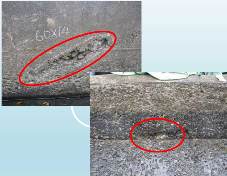
水路の壁にあいた穴
