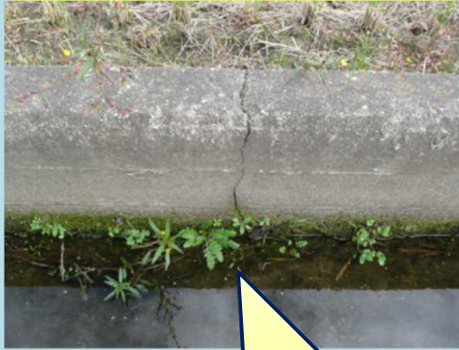
縦方向のひび割れ
