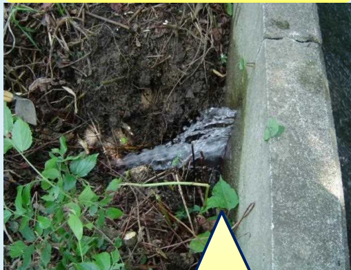
目地の開き (漏水)
