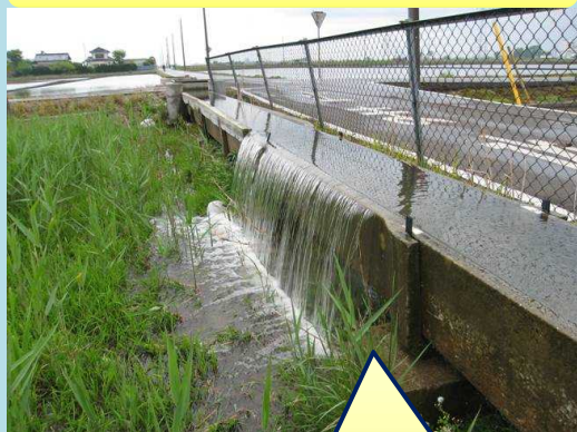
沈下による溢水
