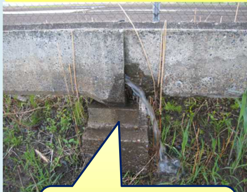
目地の開き (漏水)
