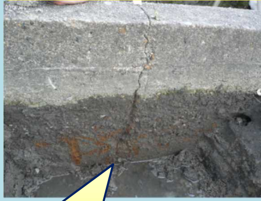
縦方向のひび割れ
