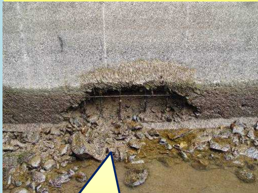
鉄筋が露出した欠損
