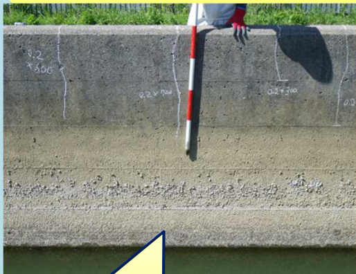
縦方向のひび割れ
