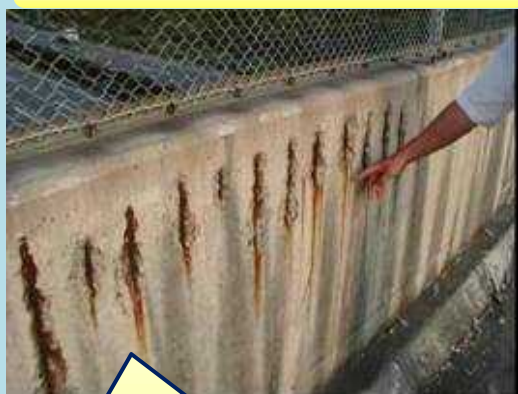
短い間隔のひび割れ
