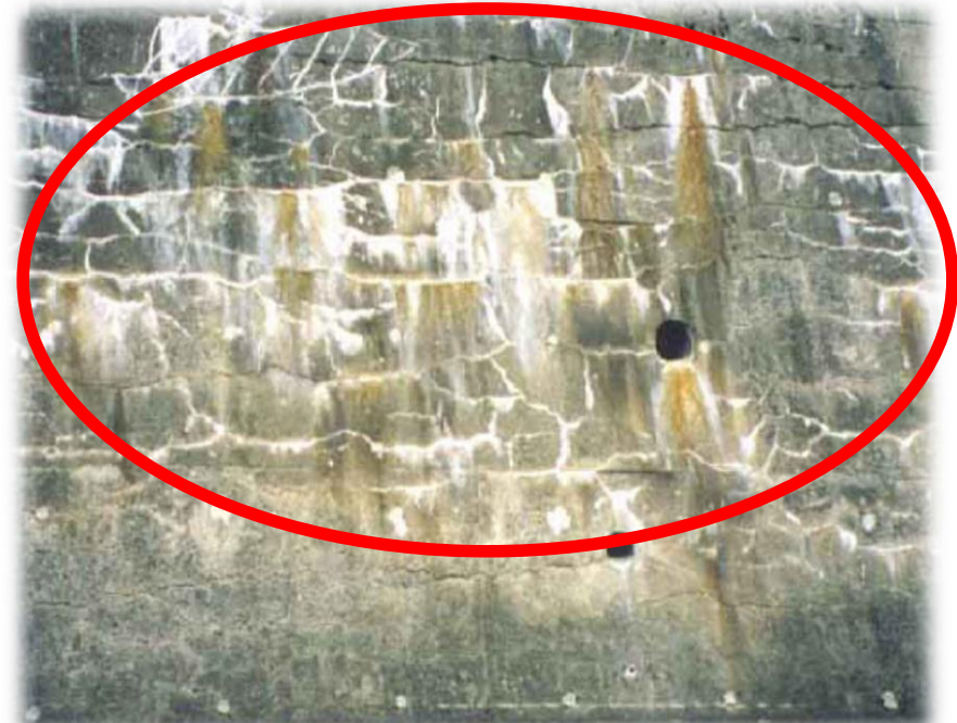
亀甲状・網の目状のひび割れ (白色の析出物を伴うことが多い)
