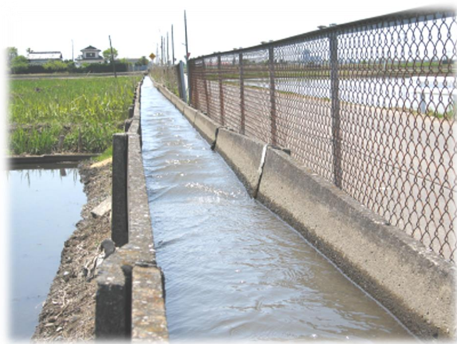
不同沈下による水路の変形
