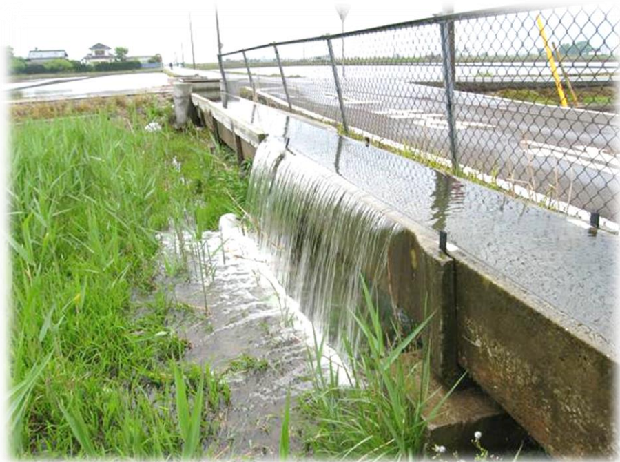
不同沈下による溢水
