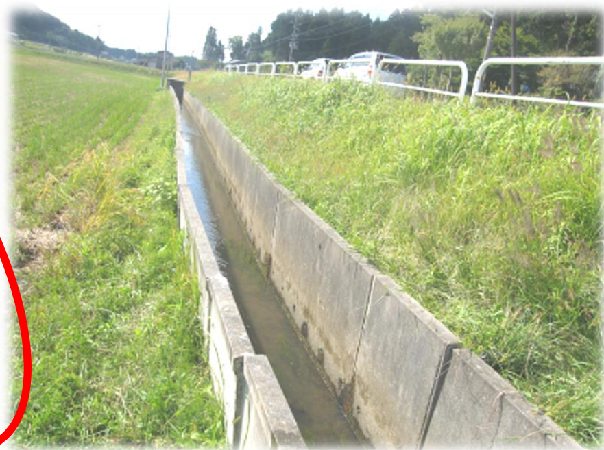
地震により側壁が 変形し蛇行した水路
