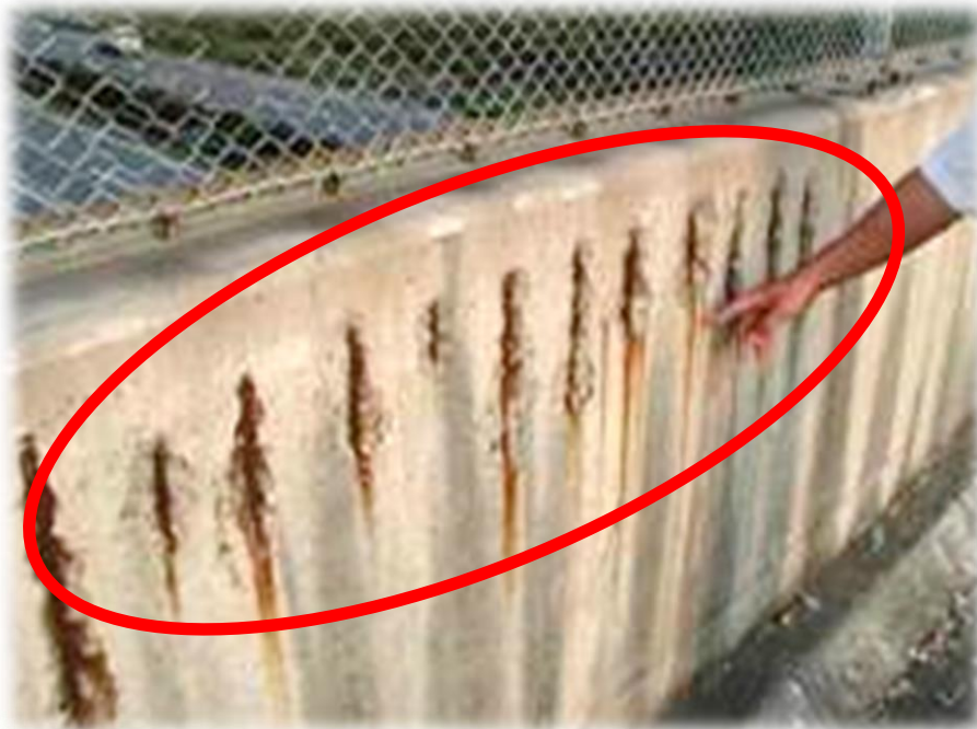
短い間隔で発生しているひび割れ (赤茶色の錆汁、鉄筋の露出を伴う)
