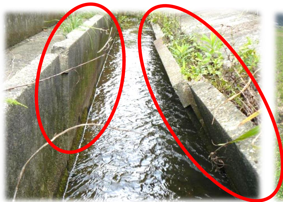
地震により側壁が 倒れ込んだ水路
