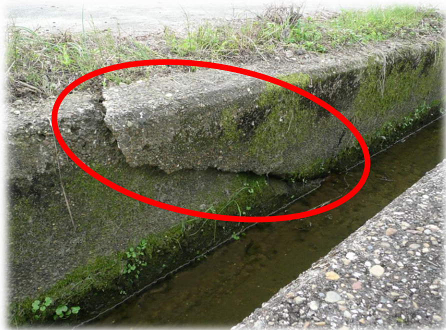
段差のあるひび割れ (大型車両が近くを通った影響など)
