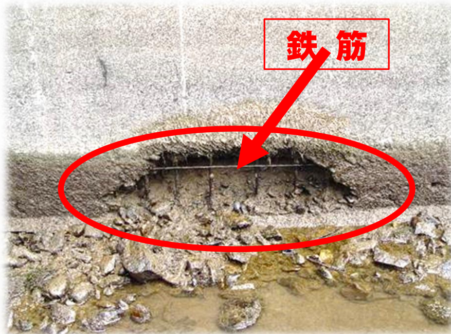
穴があき鉄筋が 露出している状態
