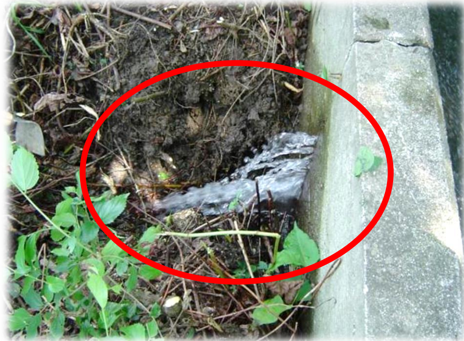
目地からの漏水
