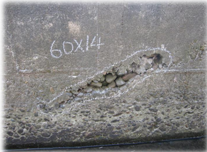
水路の壁にあいた穴
